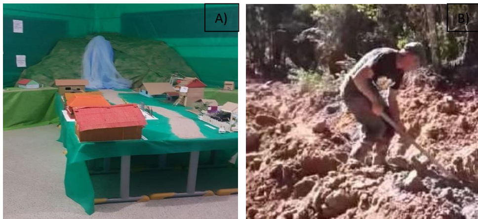
Figura 3 – A) Foto da Maquete da Serra de Araçatuba e as casas atendidas pela água, feita pelas crianças. B) Foto de morador da comunidade fazendo o encanamento.
