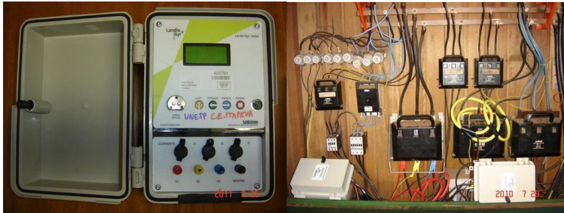
Figura 3. Em detalhes, o Analisador Portátil Saga 4500 e analisadores portáteis ligados no quadro de distribuição de energia elétrica na Serraria A.
