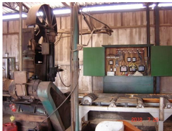
Figura 4. Serra de fita vertical e quadro de distribuição de energia elétrica na Serraria A.
