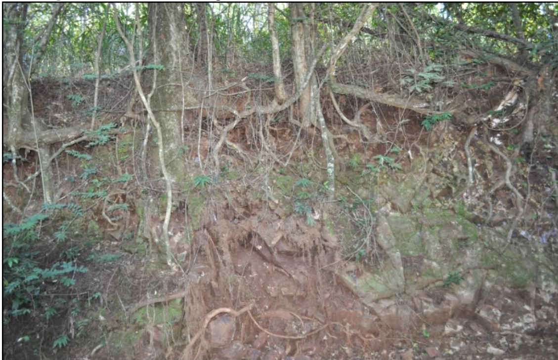
Figura 12 – Ponto 5: Intemperismo em rocha basáltica em corte de estrada.
