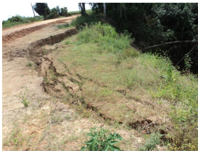
Figura 13 – Processos Erosivos no RVSMJ ao Longo da Estrada Que Delimita a Unidade de Conservação
