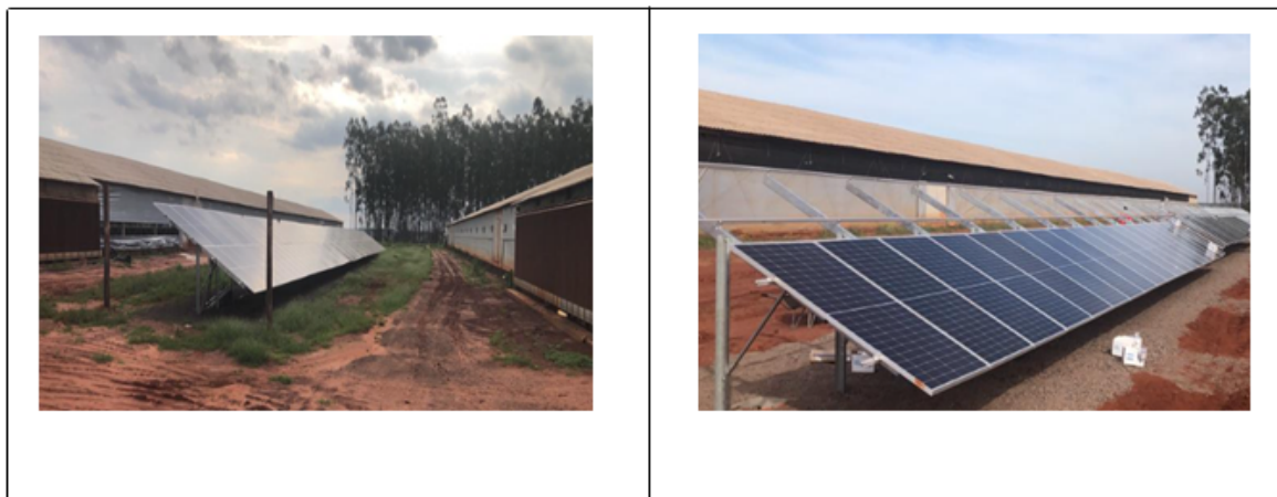
Figura 6 - Sistema fotovoltaico instalado pelo Produtor 1
