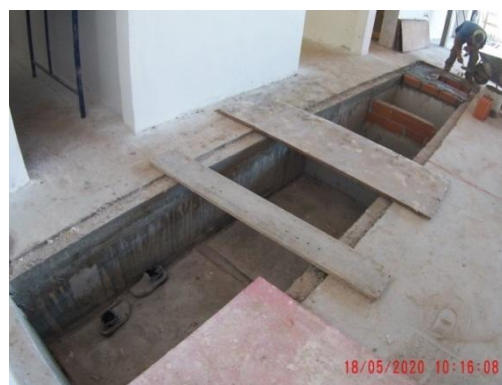
Figura 6 – Local onde foi instalado o sistema de tratamento de efluente.
