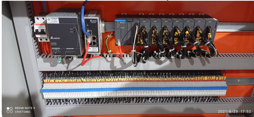
Figura 3 - Quadro de Automação.
