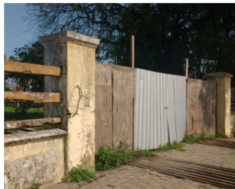
Figura 4: Bloqueio no acesso a plataforma na estação em 2017. Fonte: Castro, W. R. Data: Outubro de 2017.
