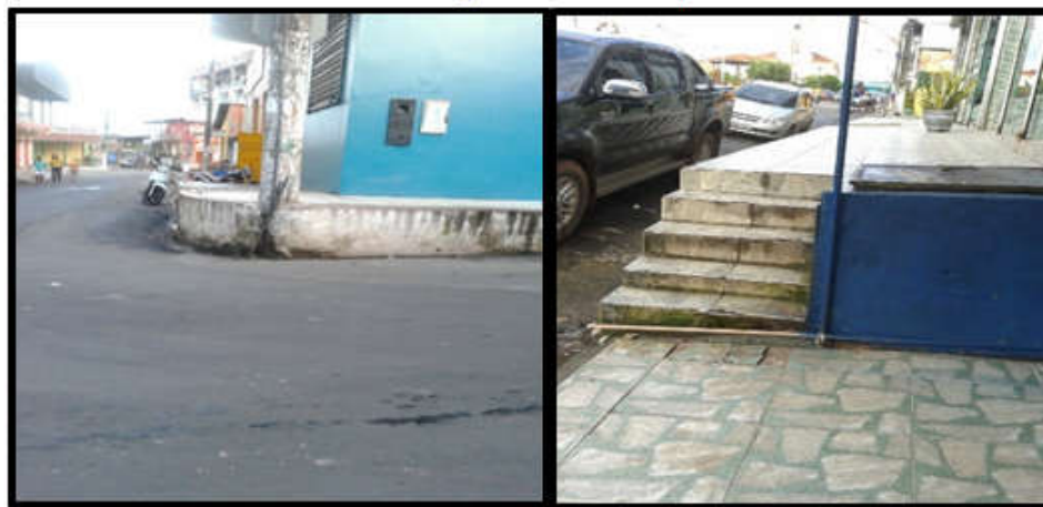
Figura 7: Calçada com alturas excessivas, escadaria e com desníveis, nas Ruas Olavo Bilac e Benjamin Constant. Org.: Nunes (2016)
